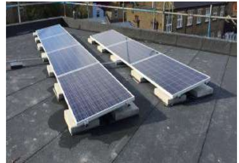
Figure 6: Châssis lestés sur une toiture
